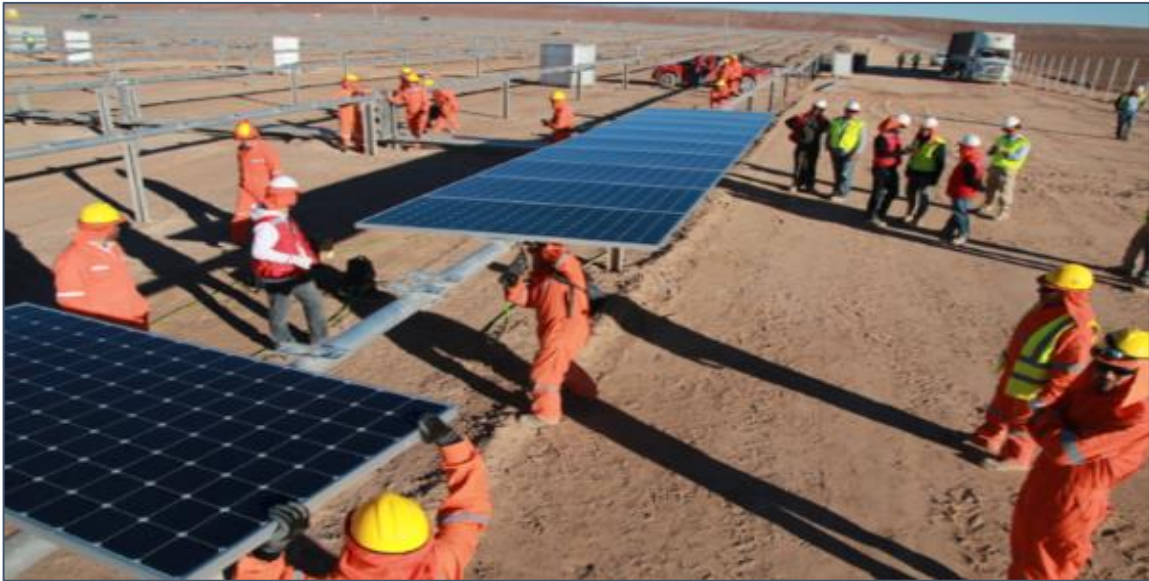
Figura 7. Ejemplo de instalación de módulos sobre los seguidores solares.
