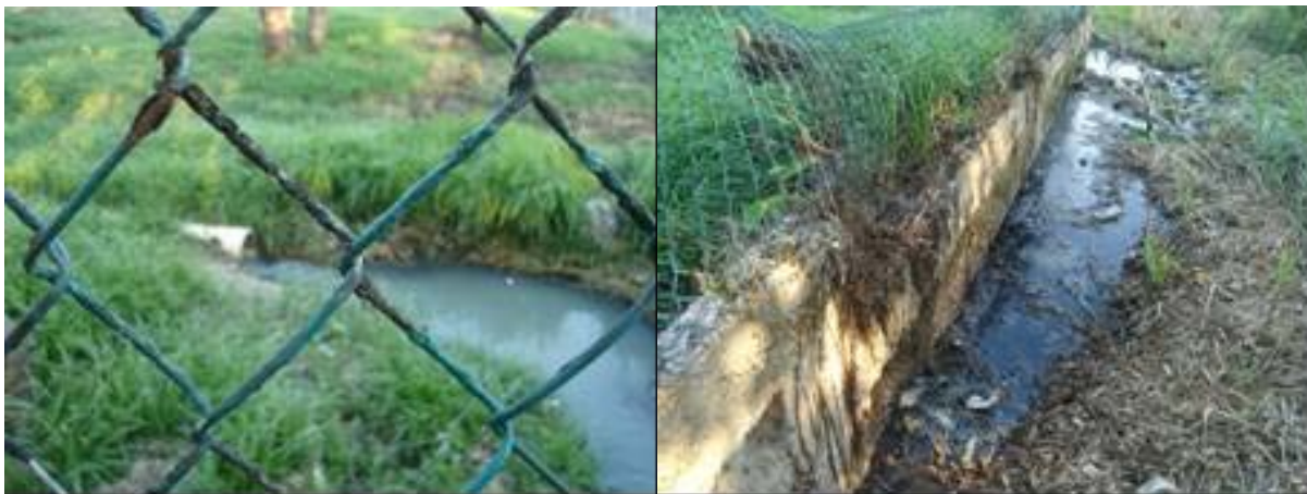
Fig. R6. Descargas de aguas negras en P13.
