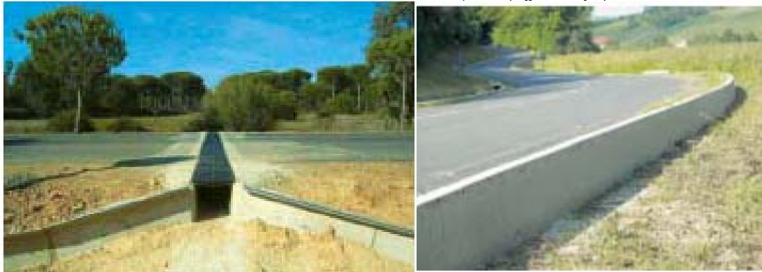
Figura 4. Cerramientos perimetrales en forma de embudo para guiar a la fauna hacia los pasos. Tomada de (Álvarez-Jiménez et al, 2006)
