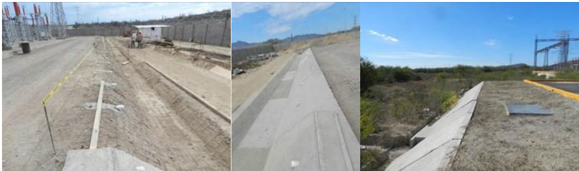
Figura.II.112. Sistema de drenajes en subestación eléctrica.
