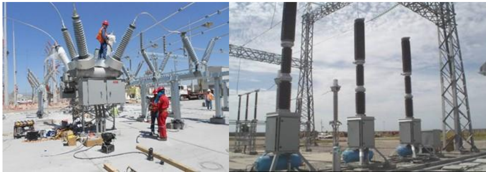
Figura.II.120. Interruptores de potencia.
