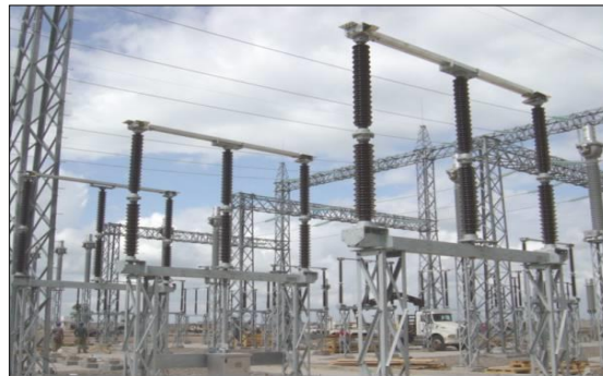
Figura.II.121. Cuchillas de potencia.
