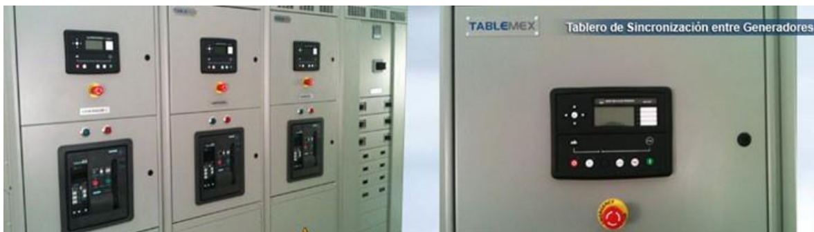
Figura.II.125. Tableros de servicios propios.
