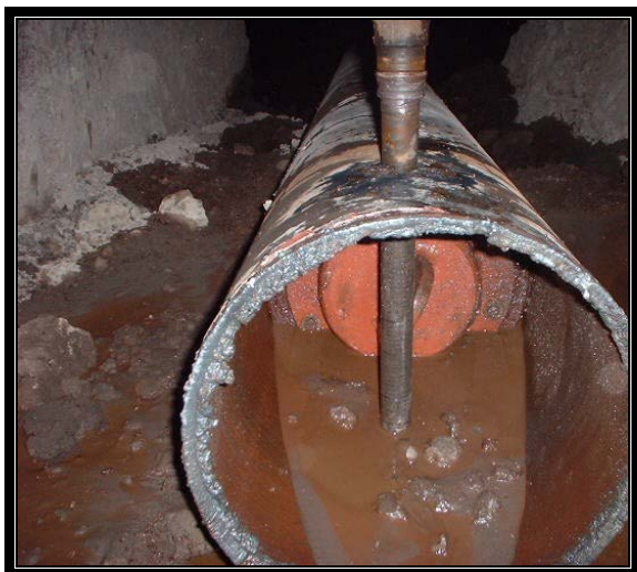
Diablo de copas dentro de tubería.
