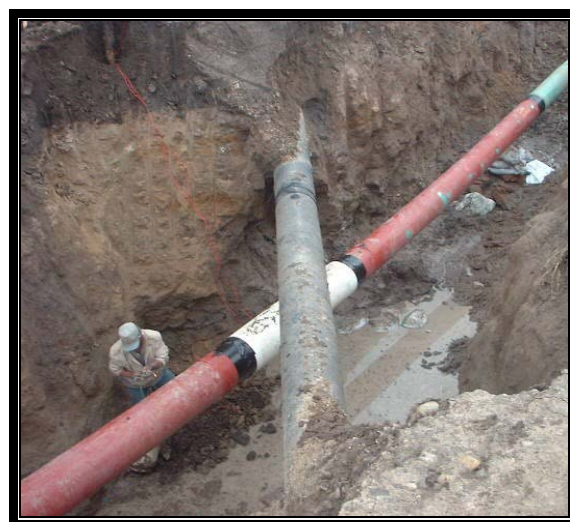
Cruce con poliducto de Pemex.
