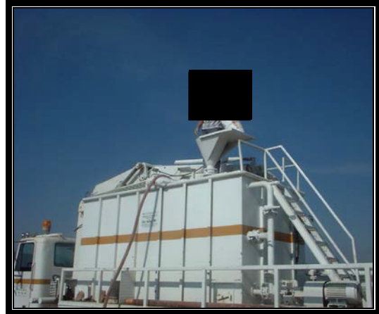
Equipo para preparación de bentonita.
