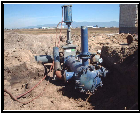
Trampa de recepción.
