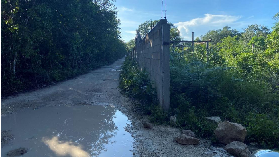
Figura VII. 2. Condiciones actuales del camino
