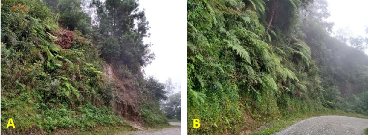
Imagen IV. 19. Vista de algunos taludes no estabilizados A ( 19^{\circ}54'53.0'' -97^{\circ}28'48.0'' ) y B ( 19^{\circ}55'1.4'' -97^{\circ}29'7.5'' ).
