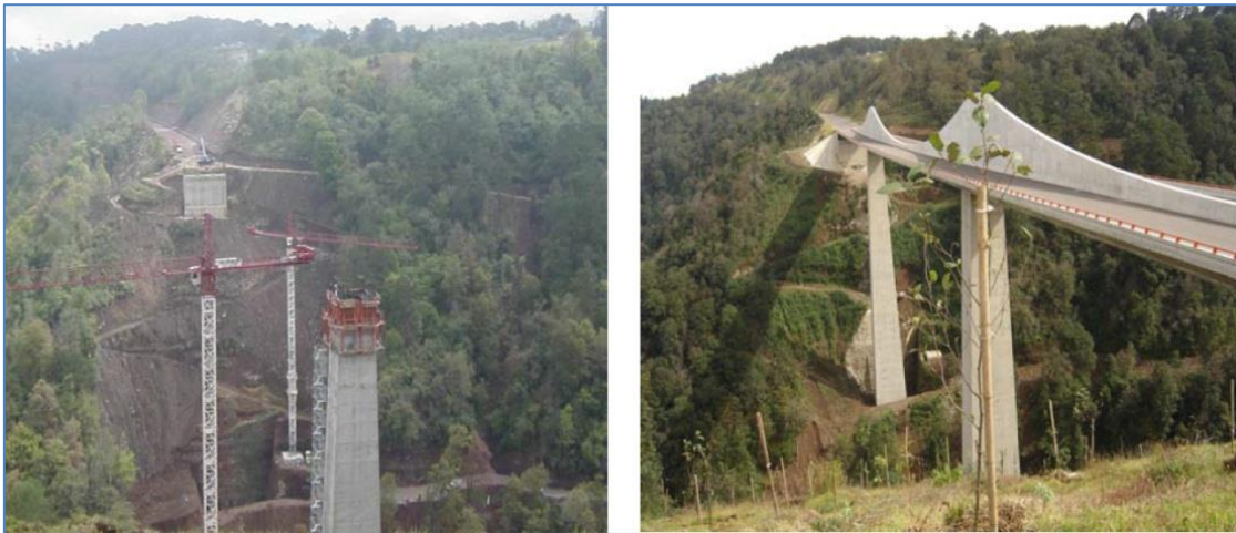
Imagen VI.52 Ejemplo de los impactos detectados sobre una ladera durante la construcción de las pilas del puente Texcapa de la autopista México-Tuxpan. Los caminos generados fueron descompactados y rehabilitados para mitigar los daños. Dicha medida de mitigación se aplicó a largo plazo, por lo que 5 años después se observa como la revegetación formó una cobertura vegetal sobre el área afectada y como las laderas presentan mayor estabilización por la presencia de vegetación.
