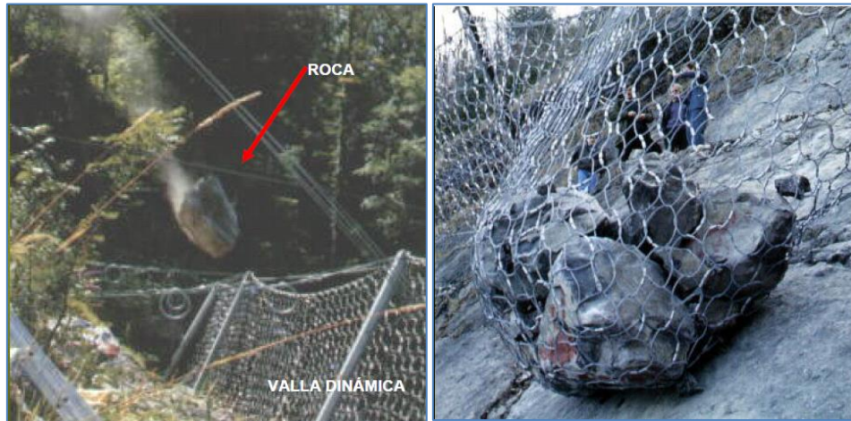
Imagen VI.12 Se observa la caída de una roca hacia las vallas dinámicas. A la derecha se observa su retención por las vallas (Alva, 2006), cuando esto suceda las rocas se podrán levantar con maquinaria a través de un mantenimiento constante en la obra para y evitar las caídas de material al Río.
