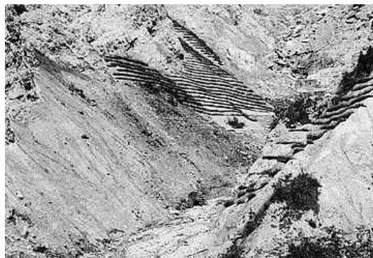
Imagen VI.29 Construcción de lechos horizontales de ramaje para la estabilización de laderas de torrentes.
