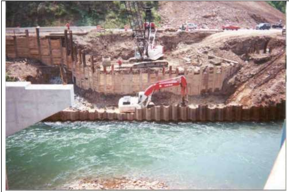
Foto II. 5. Ejemplo del uso de tablestacas durante la construcción de la cimentación de un puente en el lecho de un río caudaloso.
