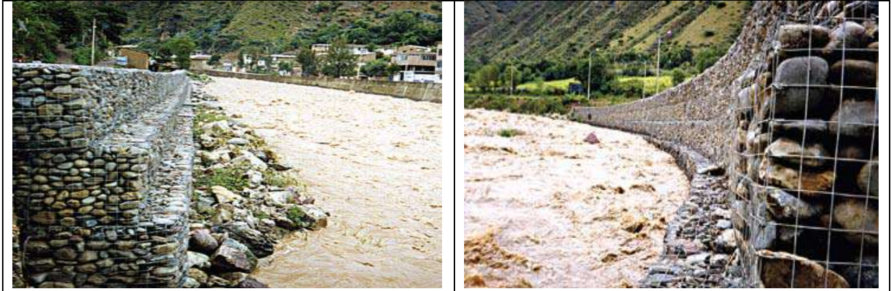
Foto II. 6. Ejemplo de colocación de gaviones instalados en las márgenes de un río.
