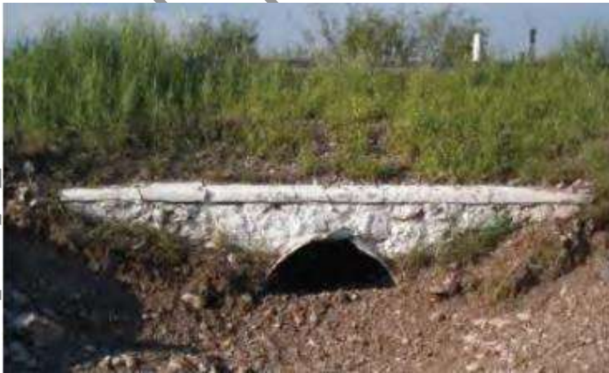
Foto VI. 20 Ejemplo de un mantenimiento deficiente del sistema de drenaje de una carretera, en donde una obra menor (tipo tubo de lámina) se azolvo interrumpiendo el drenaje del agua.
