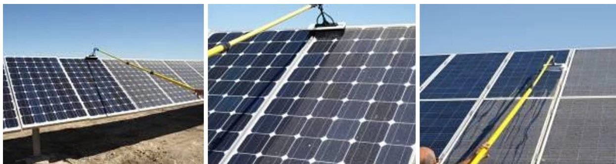
Figura II.18. Limpieza de los paneles fotovoltaicos. (Imagen ilustrativa)
