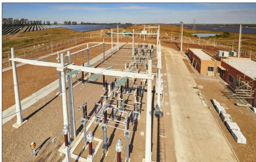
Figura II.9. Subestación Elevadora propuesta. (Fotografía de referencia e ilustrativa)
