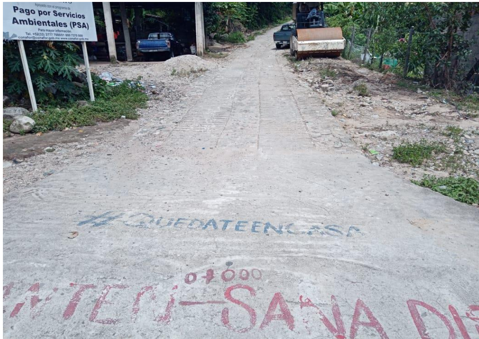
Figura 1. Inicio del proyecto "Camino: ejido 3 de Mayo - Santa Rita de las Flores, Km 0+000 donde se observa que al inicio el camino cuenta con huella de concreto hidráulico
