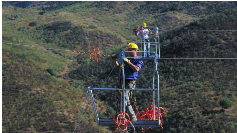
Figura 11. Colocación de dispositivos de tipo espiral 7 .
