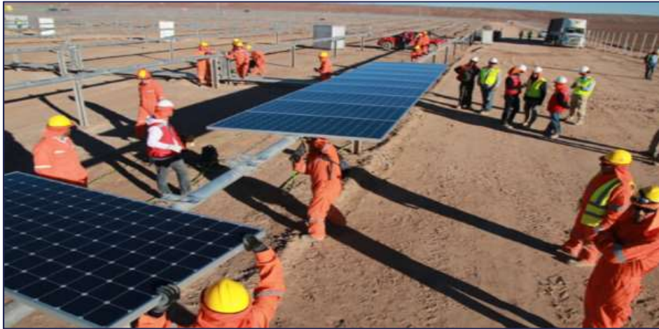
Figura II.8. Módulos sobre los seguidores solares
