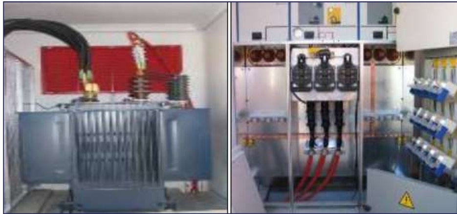
Figura II.12. Transformador y celdas de media tensión
