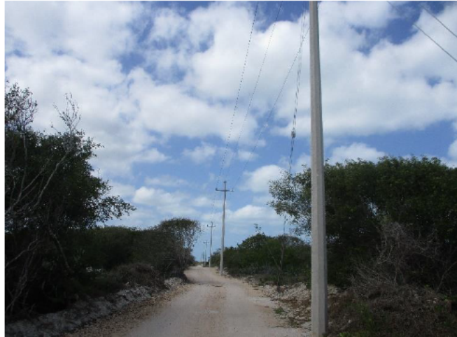
Fotografía 3 Línea de energía eléctrica en la zona.
