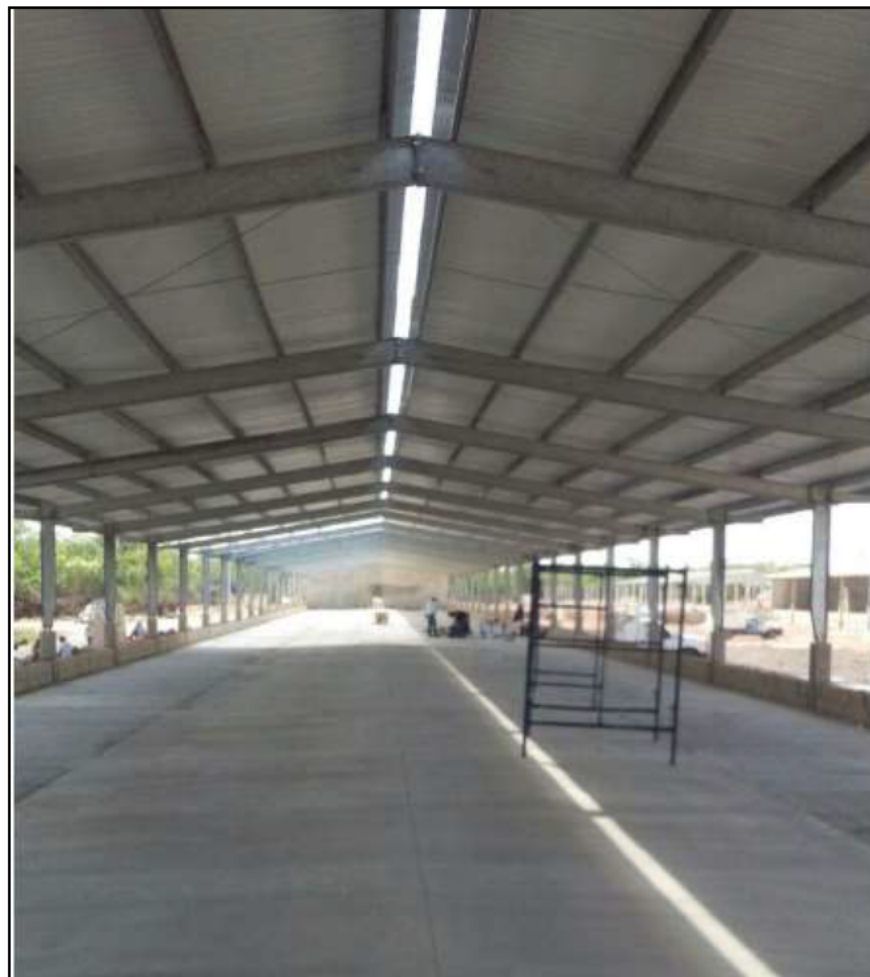
Figura II.6. Imagen ilustrativa del interior de las naves con la cimentación y estructura metálica.
