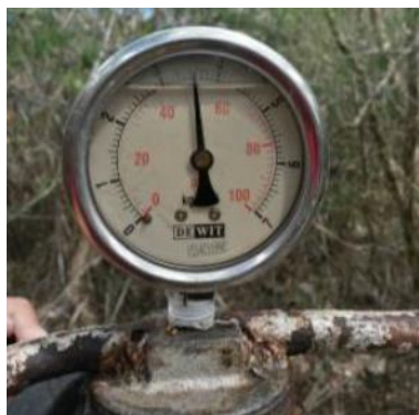
Figura 26. Vista ejemplo medidor de bomba.
