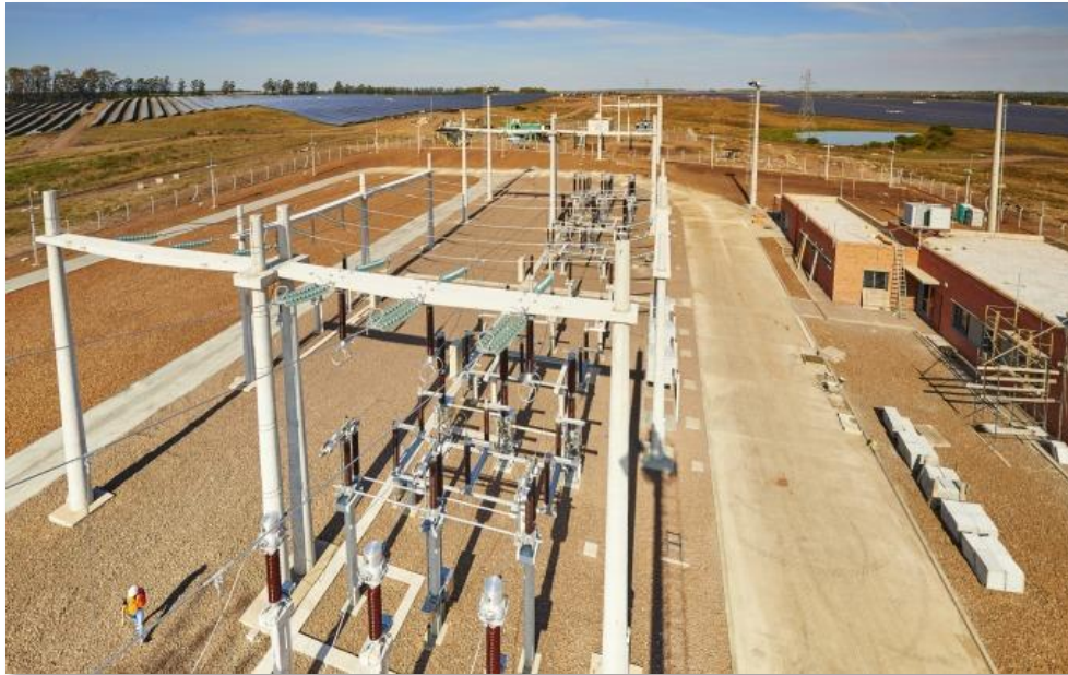
Figura II.8. Ejemplo de una subestación elevadora
