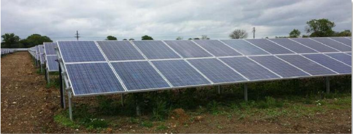
Figura II.13. Foto ilustrativa de paneles fotovoltaicos
