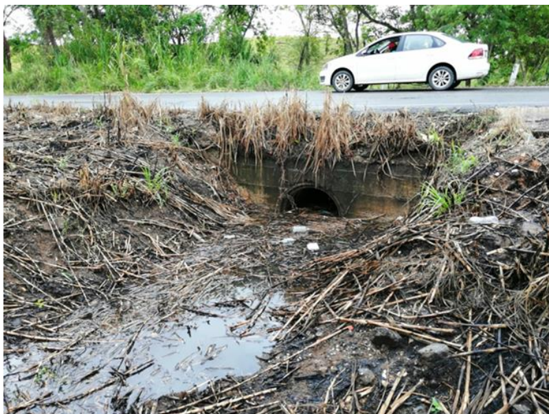
Figura 9. Obra de drenaje menor azolvada
