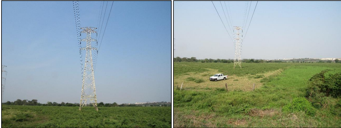
Figura 7. Líneas eléctricas dentro del pastizal cultivado en el área del proyecto.
