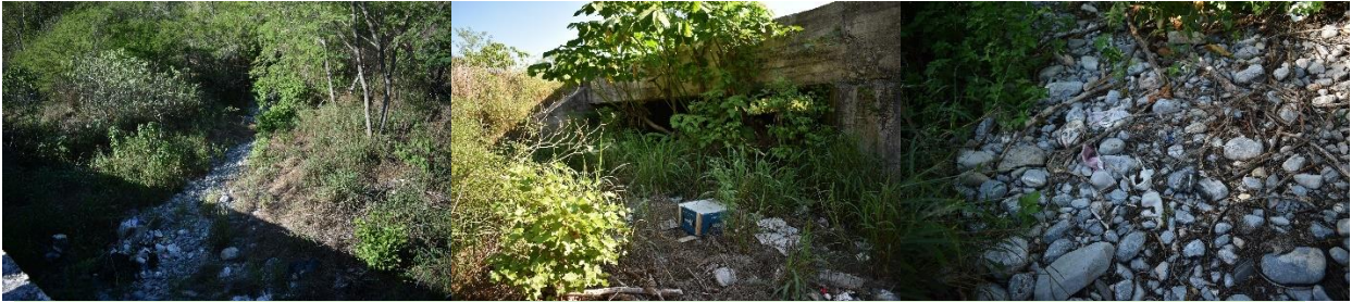
Fotografías de los cauces intermitentes en las obras de drenaje donde se puede apreciar la basura que se encuentra en estos.
