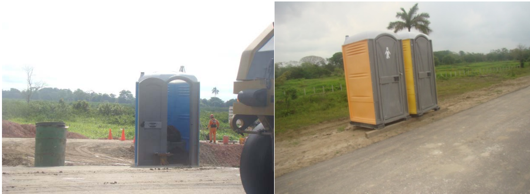
Imagen 8. Sanitarios portátiles en los frentes de obra.
