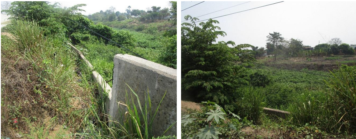
Ilustración 11. Evidencia de muro de protección colapsado que se plantea rehabilitar como parte del proyecto.
