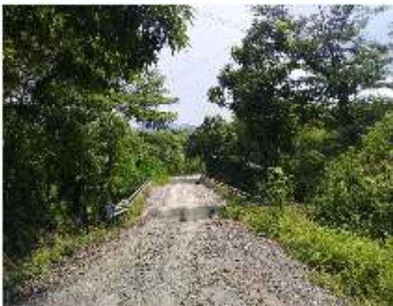
Figura 29. Puente a desnivel en el km 2+170 se observa con una carpeta asfáltica en malas condiciones.
