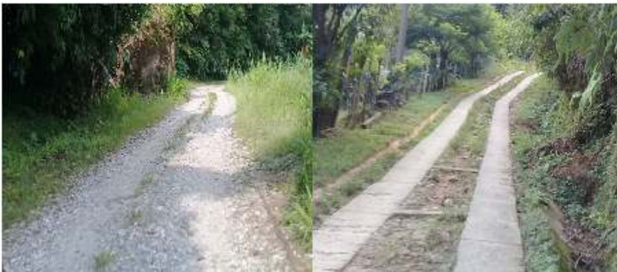
Figura 5 y 6. Condiciones actuales de la carretera la cual carece de carpeta asfáltica o solo presenta el pavimento por placa huella.
