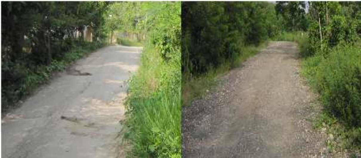
Figura 3 y 4. Condiciones actuales de la carretera la cual presenta fracturas y hundimientos y deterioro de la carpeta asfáltica en diferentes puntos.
