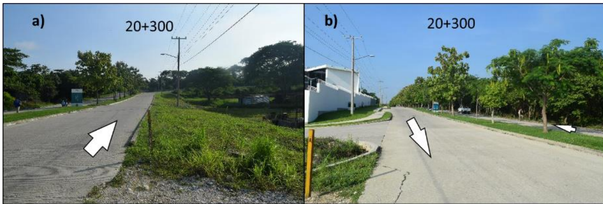
Figura 28. Vista de las condiciones actuales del Eje 20 próximo al entronque con la carretera Villahermosa- Macuspana, donde la figura a) muestra el cuerpo carretero con dirección al entronque, mientras que la figura b) muestra la carretera procedente de Cd. Esmeralda.
