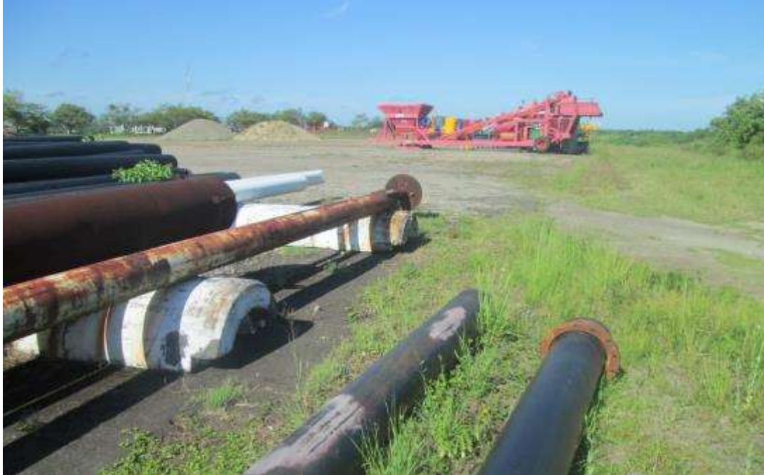
Fig.94. Plataforma a la que se le realizara las actividades de mantenimiento y rehabilitación.
