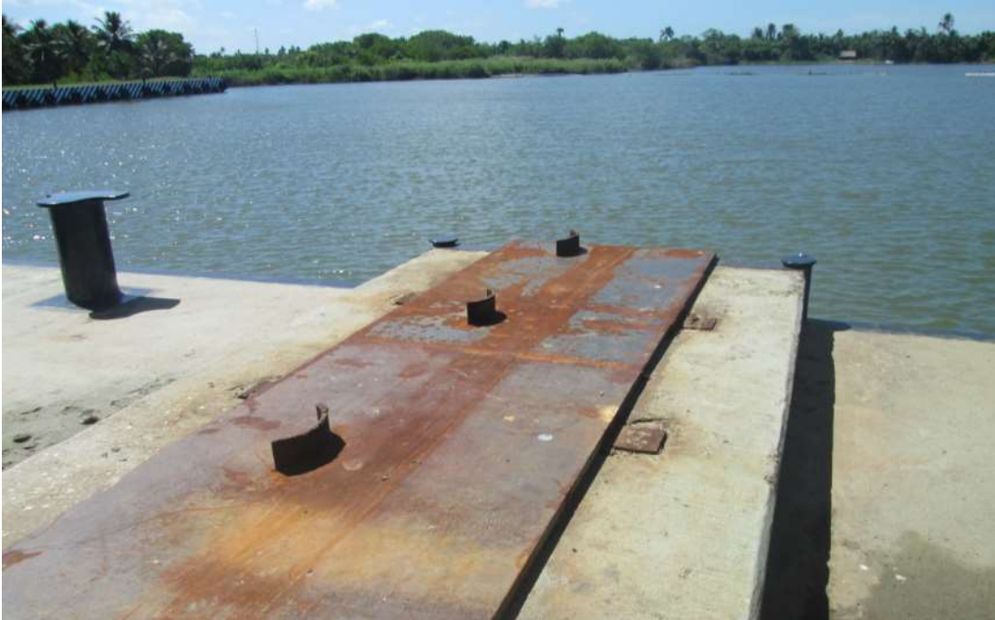
Fig.107. Área de la Corredera 1 a la que se le realizara las actividades de mantenimiento y rehabilitación.
