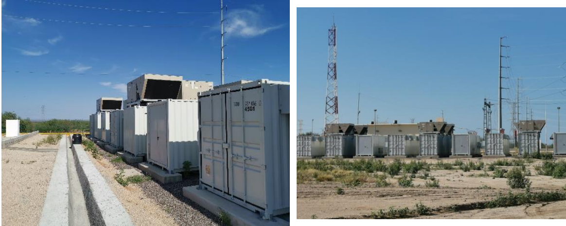
Figura II.94.- Plancha de concreto y equipos de un equipo de almacenamiento Eléctrico. Fuente: visita CFE Aura Solar, BCS.
