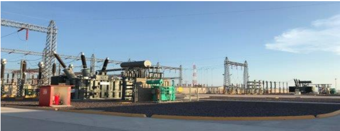
Figura II.28.- Tipo de subestación eléctrica para la interconexión del proyecto.
