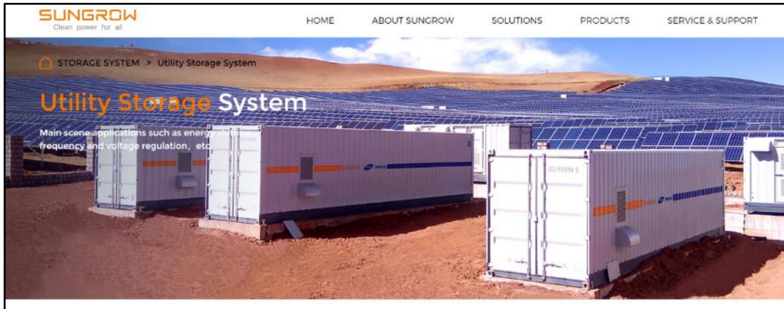
Figura II.13.- Bloque de contenedores para el sistema de almacenamiento de energía eléctrica (BESS). Fuente: https://en.sungrowpower.com/ .
