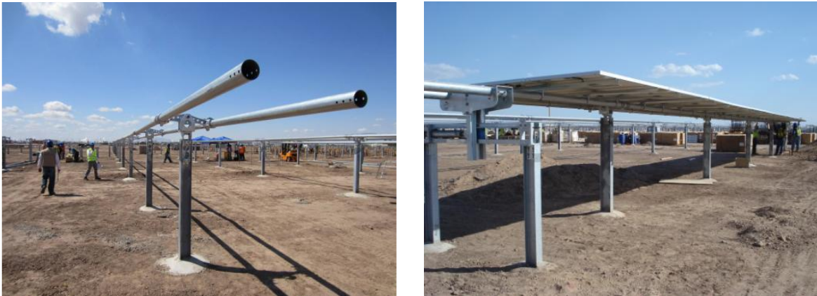
Figura II.82.- Soportes y estructuras metálicas para los módulos fotovoltaicos.
