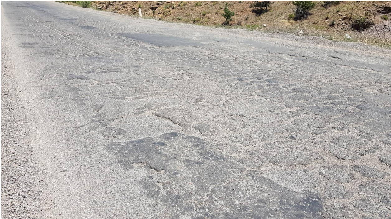
Figura II.2. Condiciones actuales de la carretera: deterioro de la carpeta asfáltica y acotamientos inadecuados
