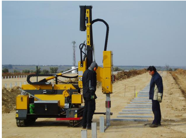
Foto II-9 Representación del hincado de los bastidores por medio de una máquina hincapostes sobre excavadora.
