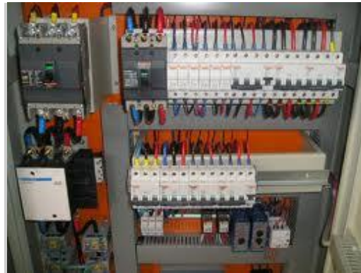
Foto II-16 Tableros de control tipo.
