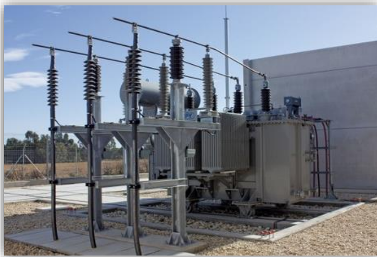
Foto II-3 Subestación eléctrica colectora tipo.
