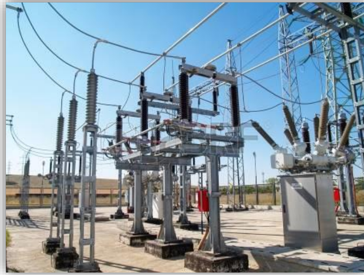
Foto II-4 Vista general de los componentes del área de maniobras de una SEM tipo.
