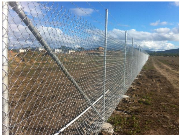
Foto II-8 Cerca perimetral tipo.
