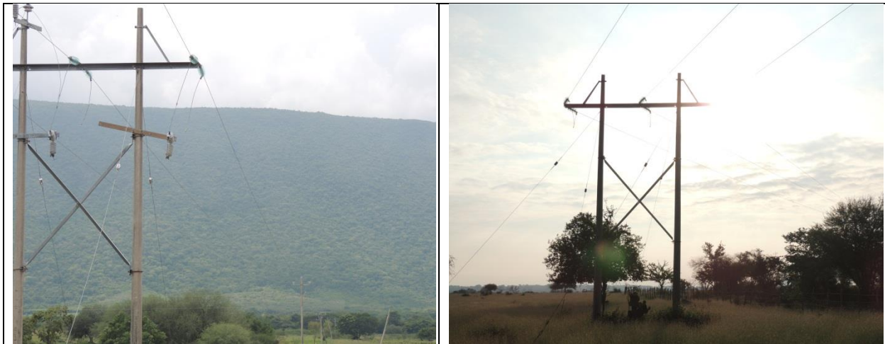
Figura IV.43 Líneas de Transmisión y Distribución presentes en el SAR del proyecto Tamuín 1
