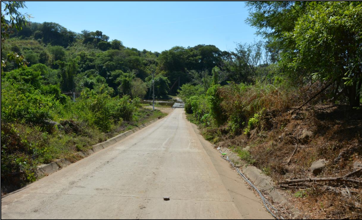
Camino a San Juan-Vado Hondo. Al fondo el vado a demoler.
