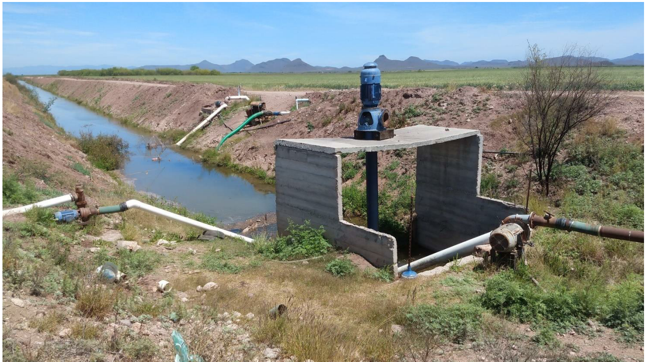
Fotografía 6. Cárcamo de bombeo.
