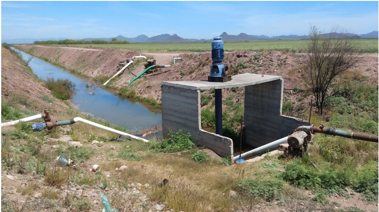
Fotografía 11. Cárcamo de bombeo.
