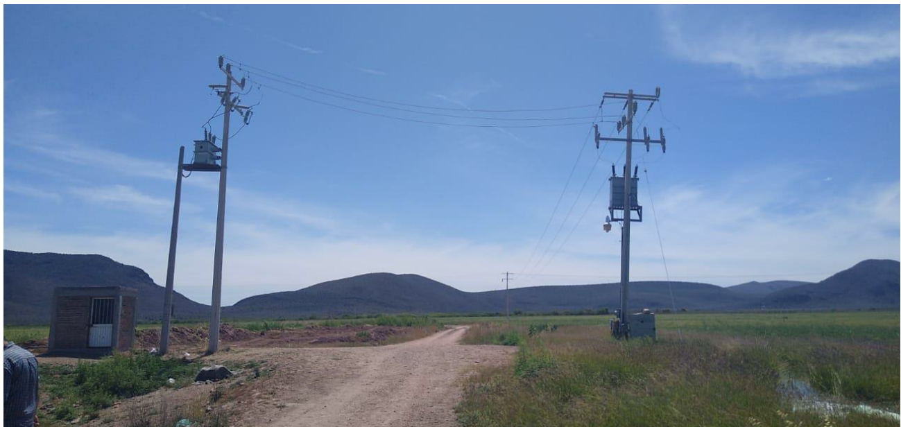
Fotografía 10. Vista del sistema eléctrico
