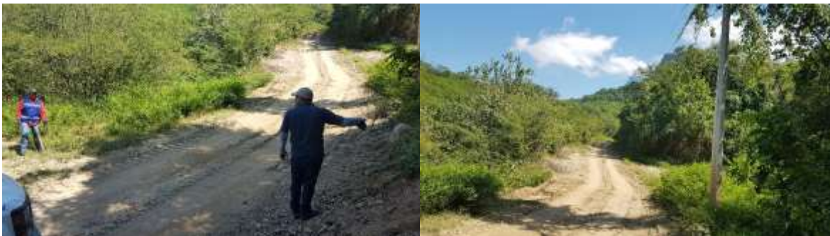
Figura II.74 Condiciones del camino actual.
