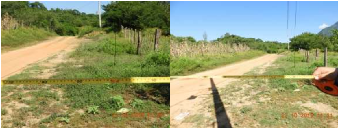
Figura II.16 Condiciones del camino actual.
