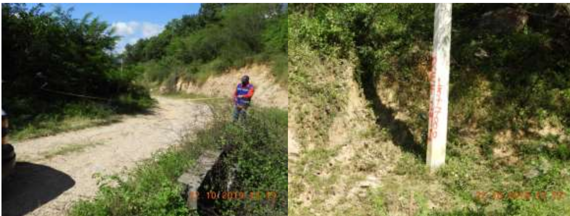
Figura II.36 Condiciones del camino actual.
