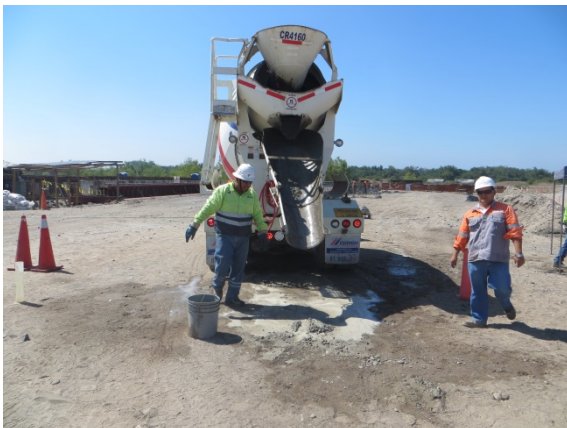
Contaminación de suelo por disposición incorrecta de residuos de mezcla y lavado de ollas.
