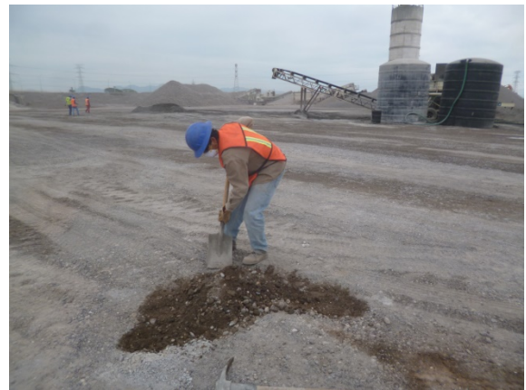
Recolección de suelo contaminado por derrame de hidrocarburos para disposición en el almacén temporal de residuos peligrosos
