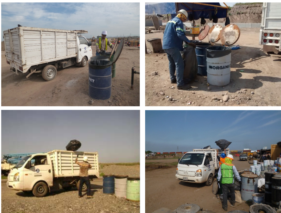
Figura II-28. Ejemplo de retiro de los residuos sólidos urbanos por una empresa privada autorizada de los frentes de trabajo habilitados.
