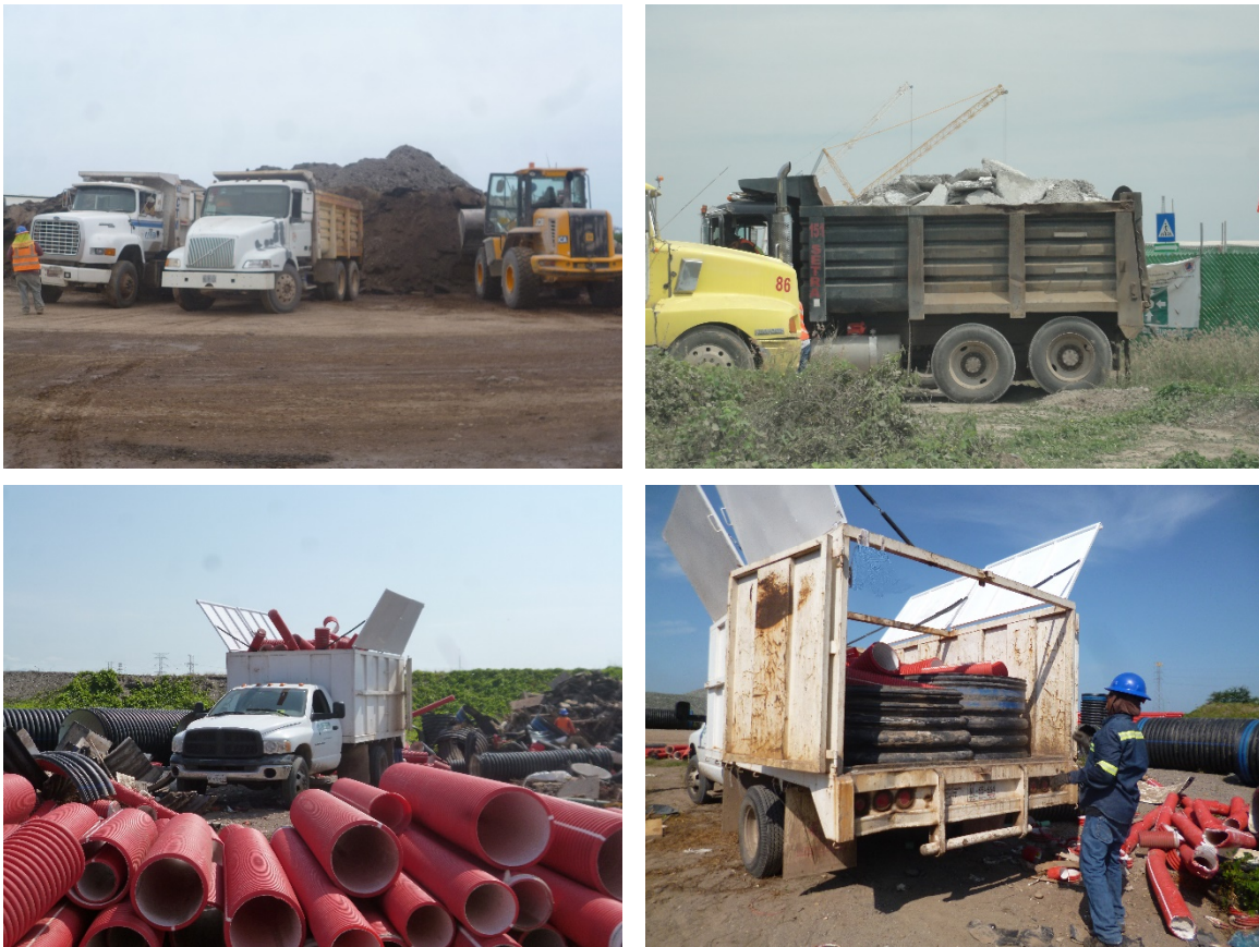
Figura II-31. Ejemplo de manejo y transporte de los diferentes tipos de residuos de manejo especial generados durante los procesos constructivos de proyectos en desarrollo.
