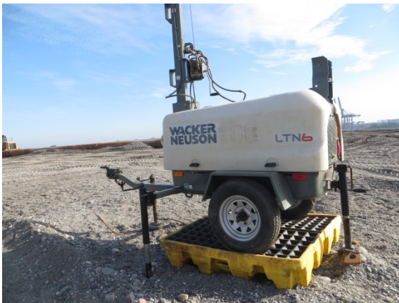
Protección de equipos contra fuga de hidrocarburos
