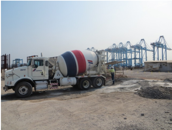
Contaminación de suelo por derrame de concreto durante el colado.
