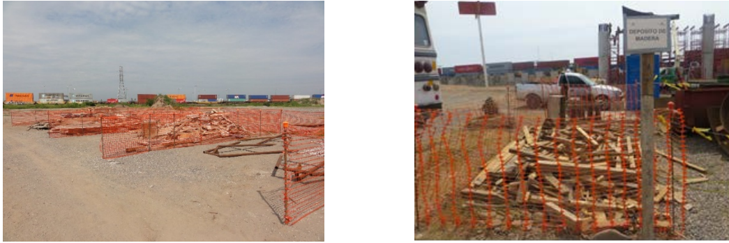
Figura II-30. Ejemplo de la habilitación y señalización de áreas para la disposición temporal de residuos de manejo especial durante la etapa de construcción.
