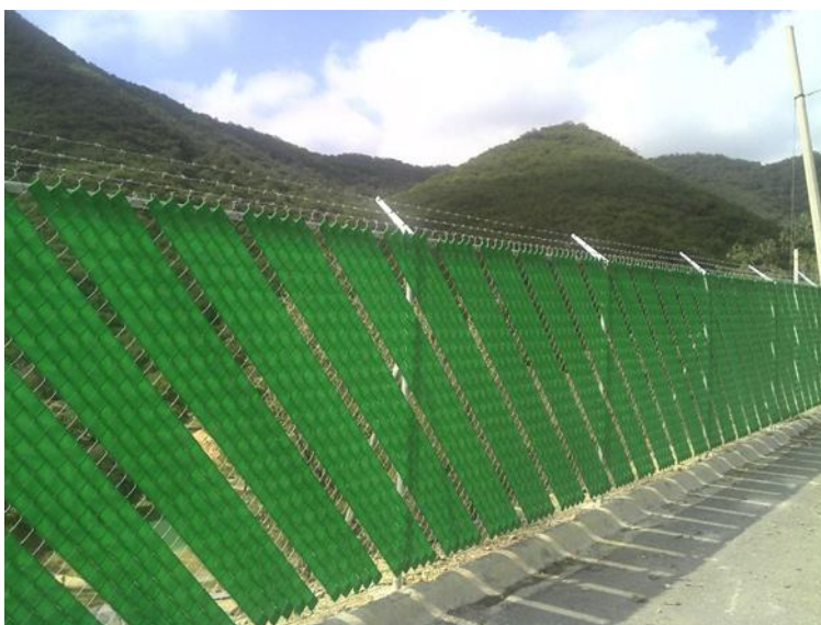
Figura II-25. Ejemplo cercado de malla ciclón para delimitar el área temporalmente.
