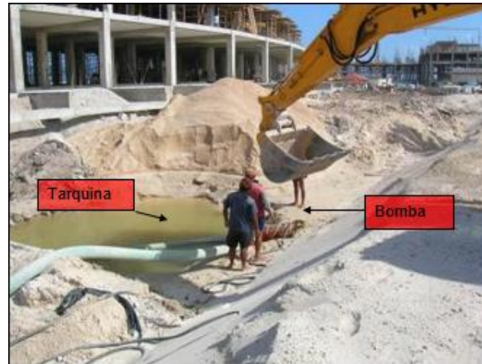
Figura 5. 17. Ejemplo de colocación de la tarquina y la bomba sumergible.
