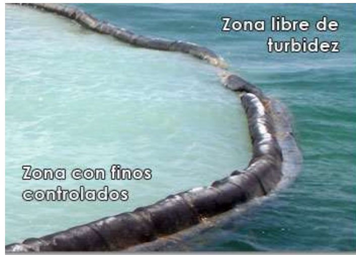
Figura VI-2. Colocación de geotextil para control de sólidos re-suspendidos Fuente: tomada de internet como referencia.
