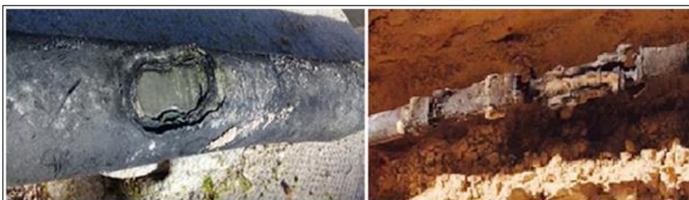
Figura II-5. Daños del aislamiento de cable submarino en operación.
