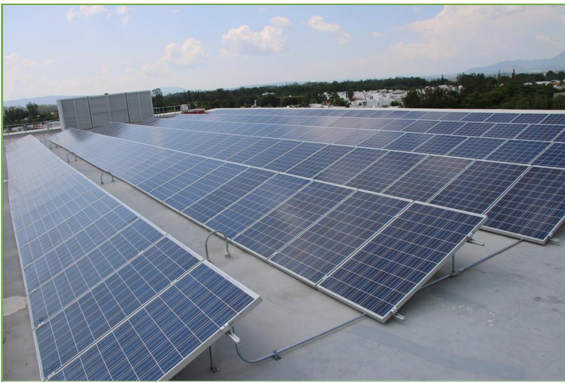
Figura 7. Ejemplo de paneles solares instalados en la azotea de un edificio.
