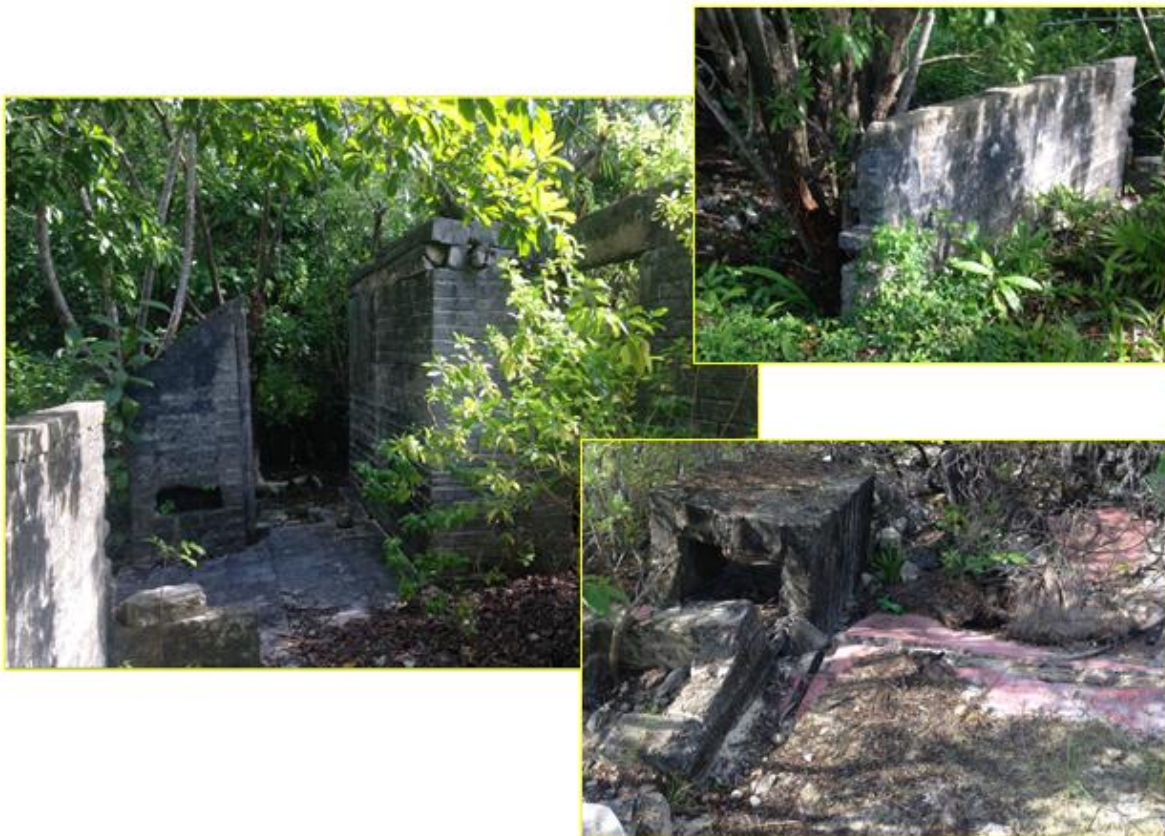
Ruinas de obra civil
