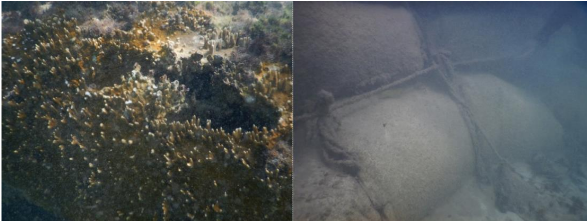
Figura 117. Vistas submarinas de las estructuras de protección existente frente al hotel Sandos Caracol, sección Centro expuesto (C-exp), para el muestreo de la época de secas. Izquierda: parte somera de la estructura; derecha: amarres de contención.
