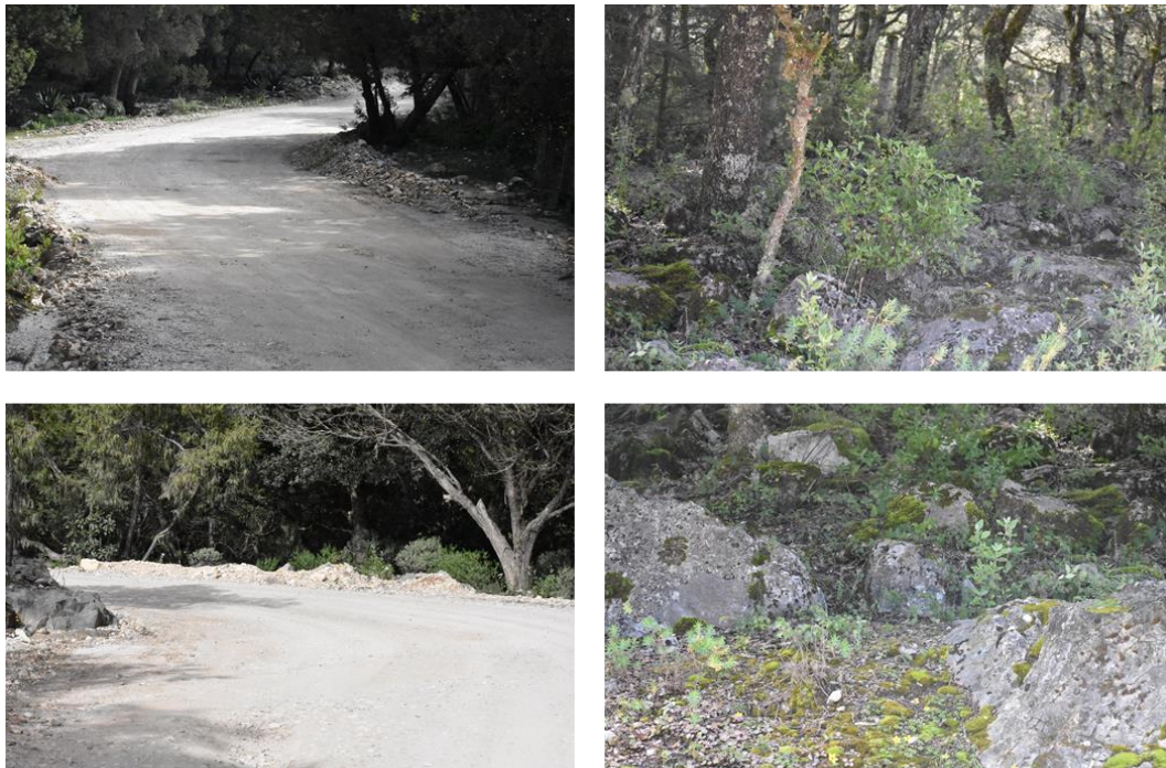
Figura 65. Condiciones del escurrimiento superficial localizado en el km 1+055.
