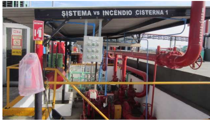
Foto 10. Sistema de Contra Incendio
