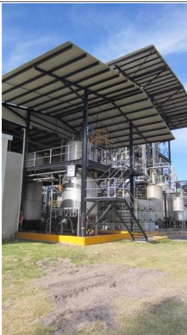
Foto 3. Área de producción Mezclas Sección II, que consiste en: 2 tanques verticales de mezclado de 25 m 3 cada uno, sus cimentaciones y un condensador similar al de Citrathals.
