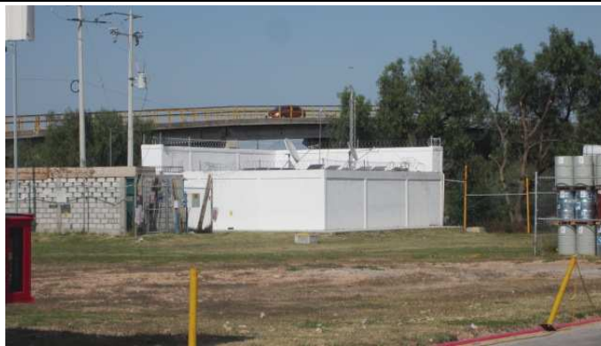
Foto 12. Medición Gas Natural (City Gate)
