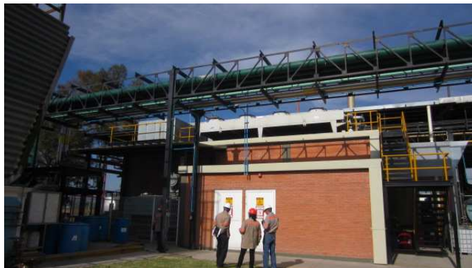
Foto 13. Área de calderas y calderines, cogeneración
