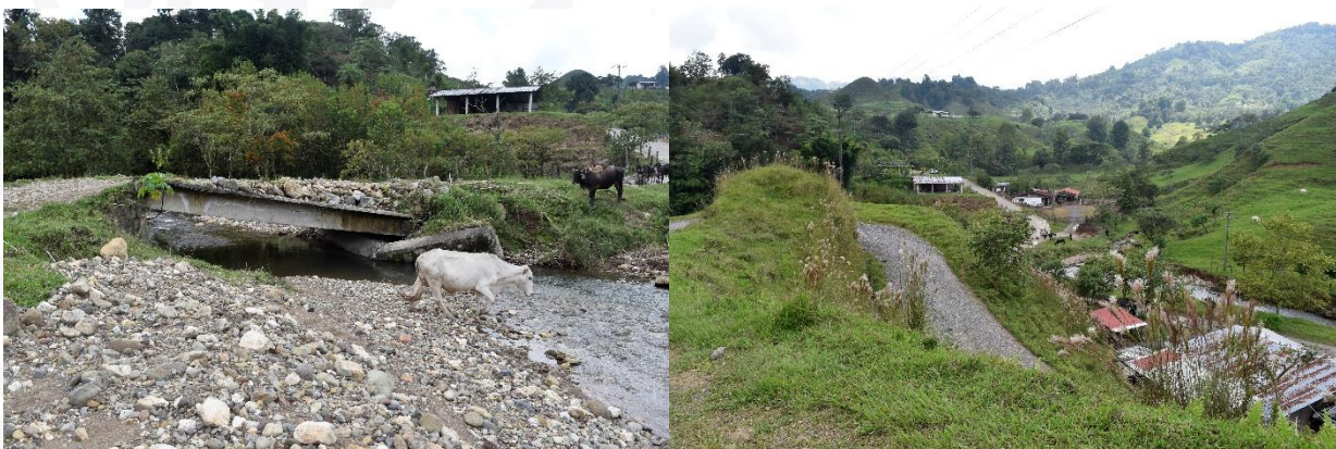
Fotografías del puente y panorámica en donde se observan los manchones desprovistos de vegetación natural por la creación de campos para cultivo o pastoreo, así como asentamientos humanos.
