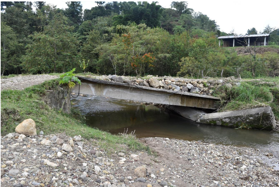
Fotografía del puente existente en el km 2+562 del camino Tlapacoya Zoquiapa, en la localidad de Zoquiapa, en el municipio de Tlapacoya.
