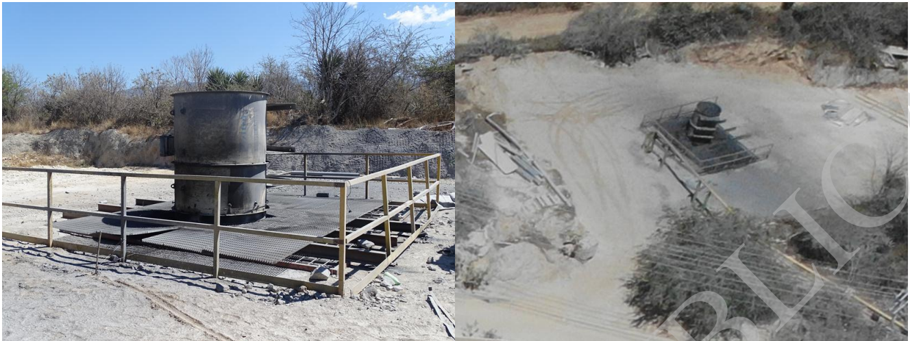
Figura 2.48. Vista general de las Obras asociadas al contrapozo 2 y vista aérea tomada con Dron en marzo de 2019
