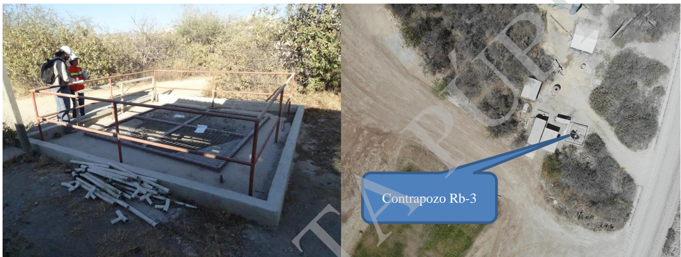
Figura 2.50. Vista general de las Obras asociadas al contrapozo (Rb-3) y vista aérea tomada con Dron en marzo de 2019
