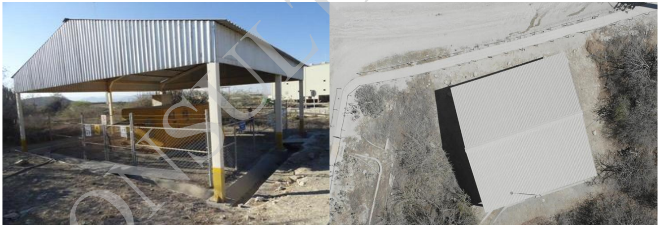
Figura 2.83. Vista general de la subestación eléctrica que alimenta a mina y vista aérea tomada con Dron en marzo de 2019
