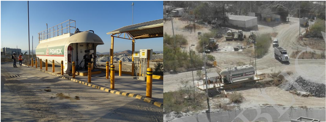
Figura 2.77. Vista general de la Estación de combustible de 40,000 litros y vista aérea tomada con Dron en marzo de 2019
