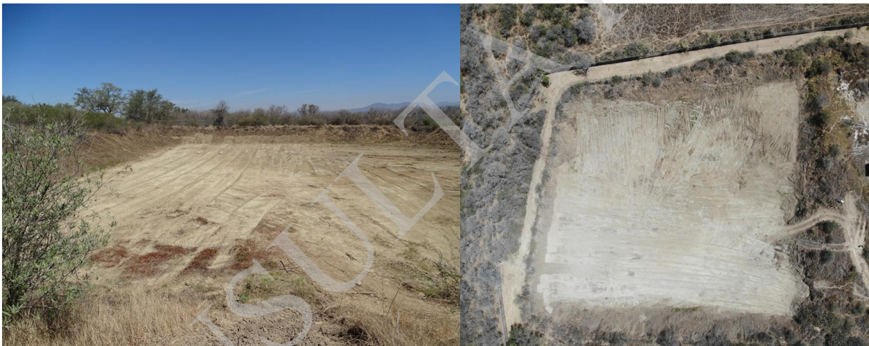
Figura 2.27. Vista general de la pileta de captación de agua pluvial, Norte y vista aérea tomada con Dron en marzo de 2019
