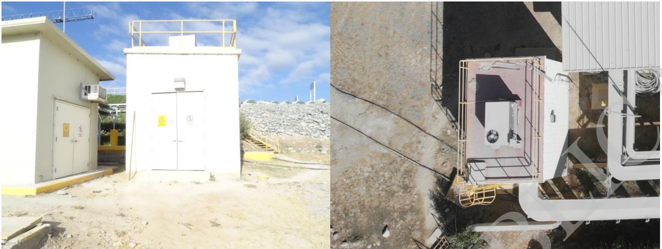
Figura 2.19. Vista general del Cuarto eléctrico y vista aérea tomada con Dron en marzo de 2019
