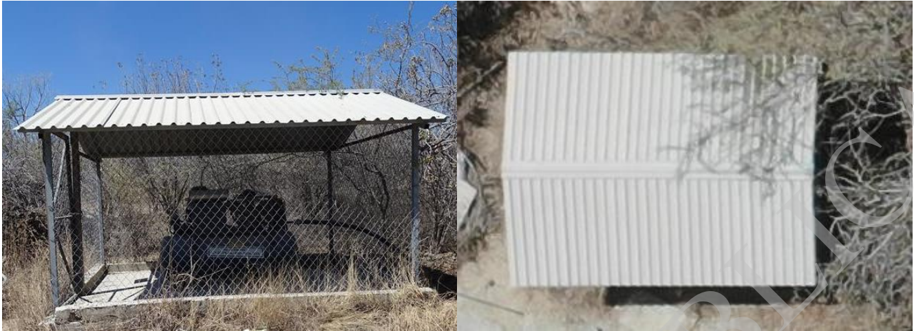
Figura 2.41. Vista general del Compresor de aire y vista aérea tomada con Dron en marzo de 2019
