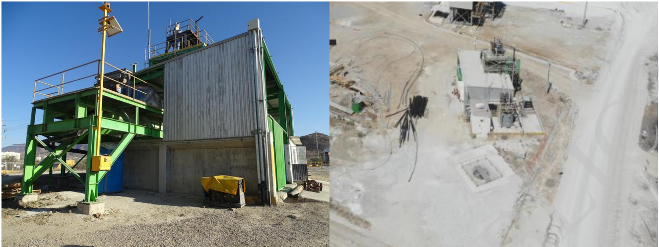
Figura 2.51. Vista general del Relleno hidráulico y vista aérea tomada con Dron en marzo de 2019
