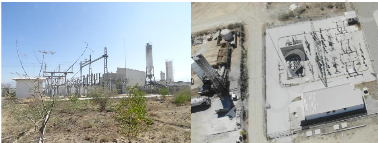
Figura 2.65. Vista general de la subestación eléctrica principal y vista aérea tomada con Dron en marzo de 2019
