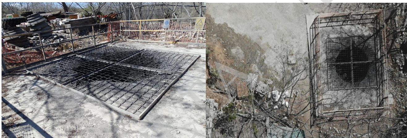
Figura 2.84. Vista general del Contrapozo Rb-9 y vista aérea tomada con Dron en marzo de 2019
