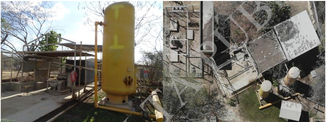
Figura 2.32. Vista general del área de compresores y vista aérea tomada con Dron en marzo de 2019
