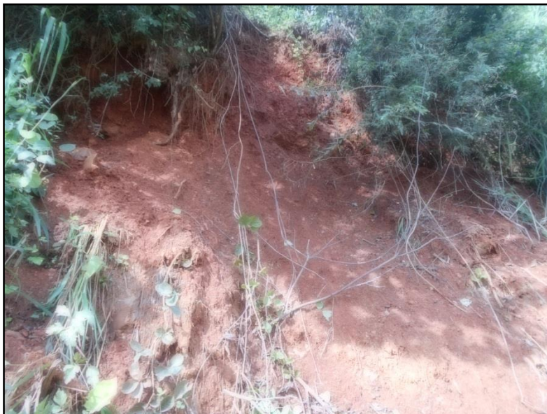
Fig. 4.11. Pequeño deslizamiento de suelo sobre un corte aledaño al camino
