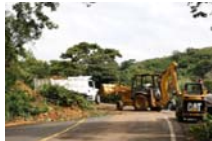
MM-6. Monitoreo mecánico y de emisiones a la maquinaria y equipo utilizado en la obra.
