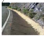
MM-10. Construcción de cunetas en las zonas laterales del ancho de calzada.
