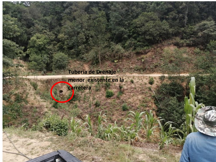
Foto 41. Vista del la marca de km 8+000 hacia 0+000 se puede ver una curva muy pronunciada (retroceso) el cual se puede observar los drenajes
