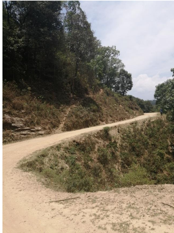
Foto 9. Vista del camino a partir de la marca de km 1+000 hacia km 0+000, a la margen derecha, se puede observar brechas que los pobladores hacen para acceder a la parte alta del cerro en busca de hierbas y vegetación para su uso, además de acortar su traslado.
