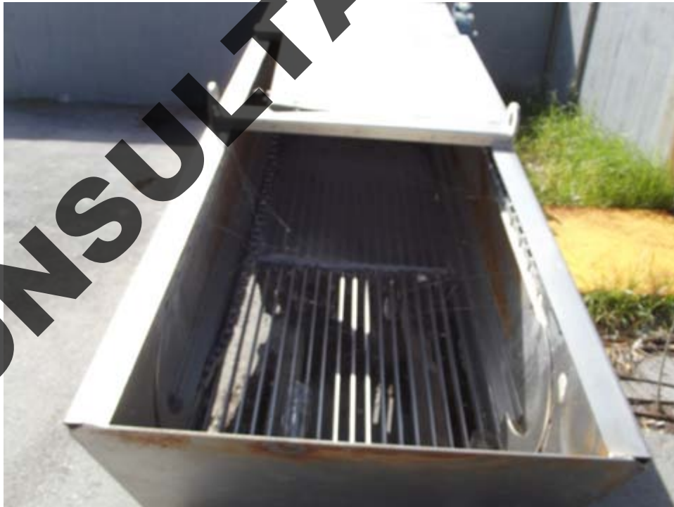
Fotografía No. 3 Rejillas automatizadas
