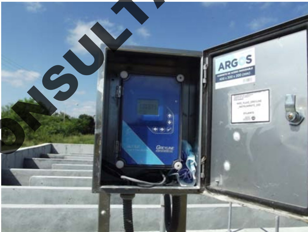
Dosificación de cloro
