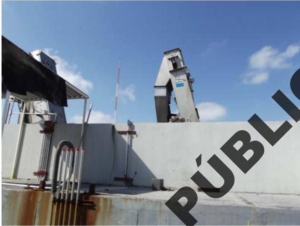
Fotografía No. 2 Sistema de rejillas
