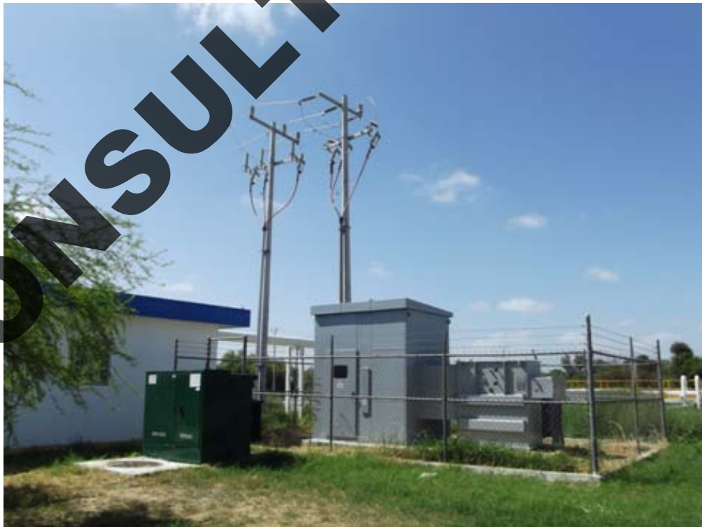
La planta cuenta con una unidad de transformador de energía eléctrica
