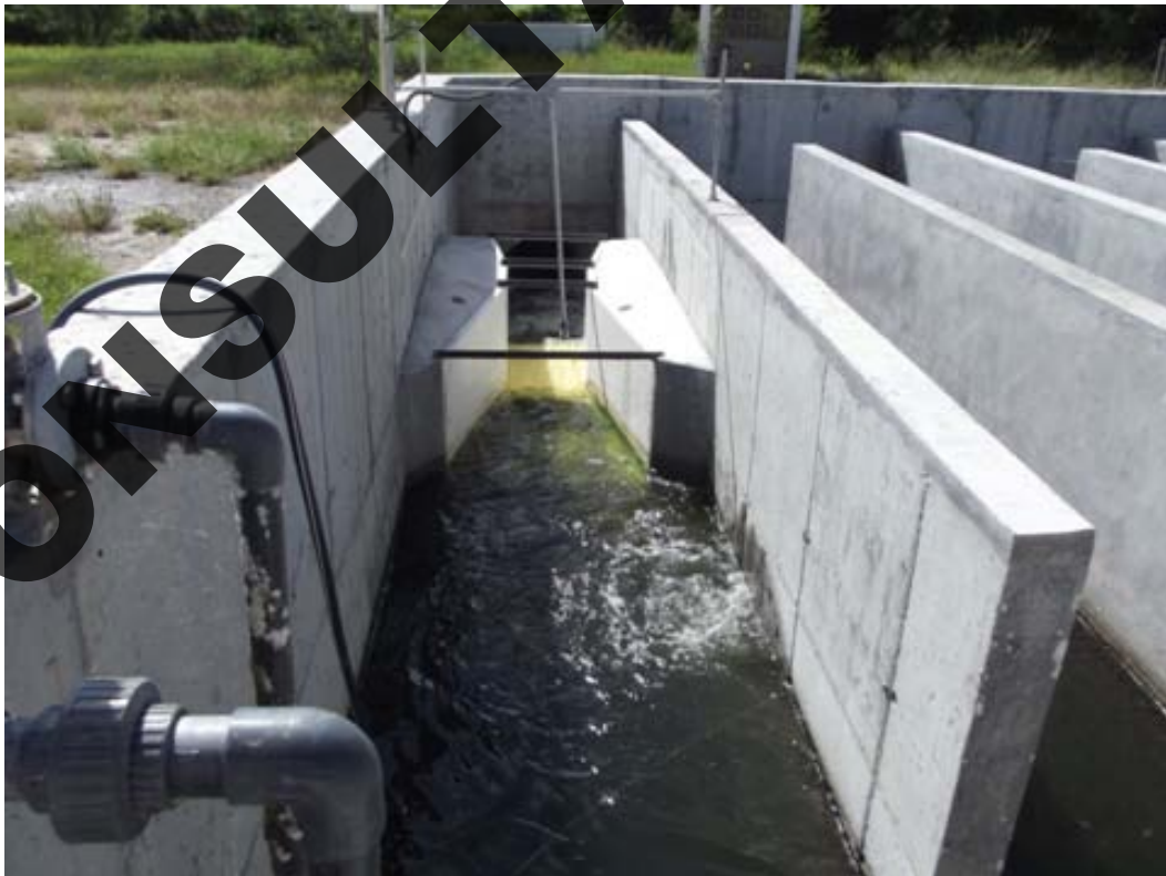
Tanque de contacto de cloro
