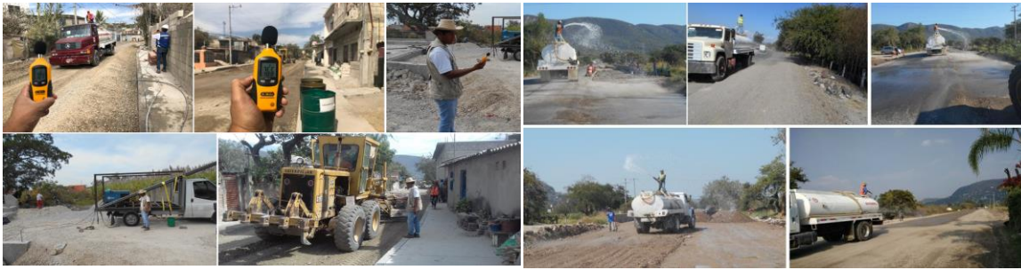
Figura VI.4. Riegos de apoyo para evitar la volatilización de partículas producto de las actividades de construcción del proyecto, monitoreo de ruido durante procesos constructivos (imágenes de archivo, 2018).
