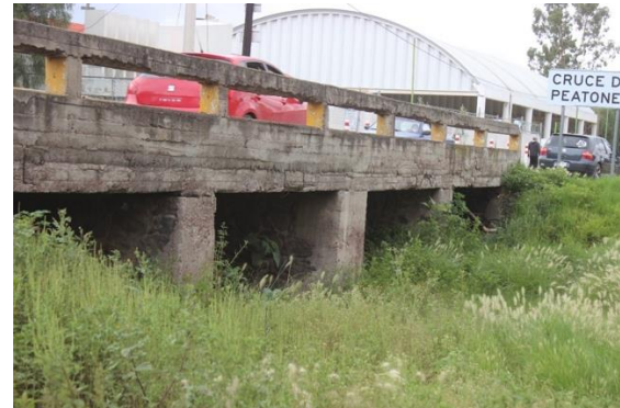
Puente vehicular sobre corriente de agua intermitente ciega, ya que no tiene continuidad por estar obstruida por rellenos
