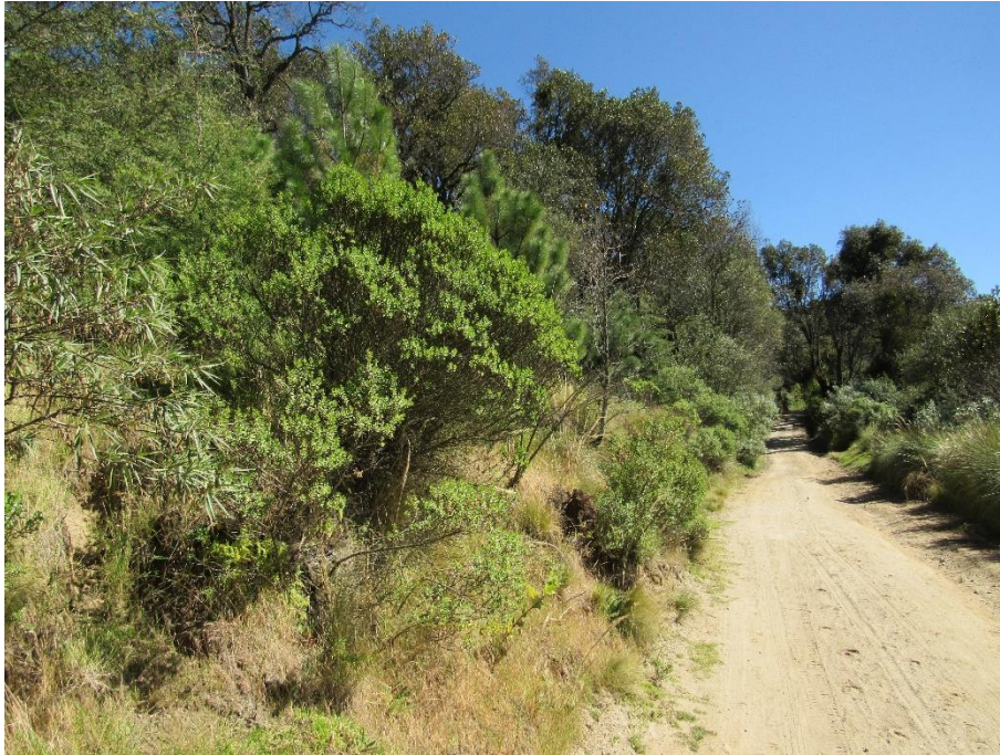
Figura 28. Aspecto del camino en el Km 4+300, hacia adelante, la afectación es del lado izquierdo de la imagen
