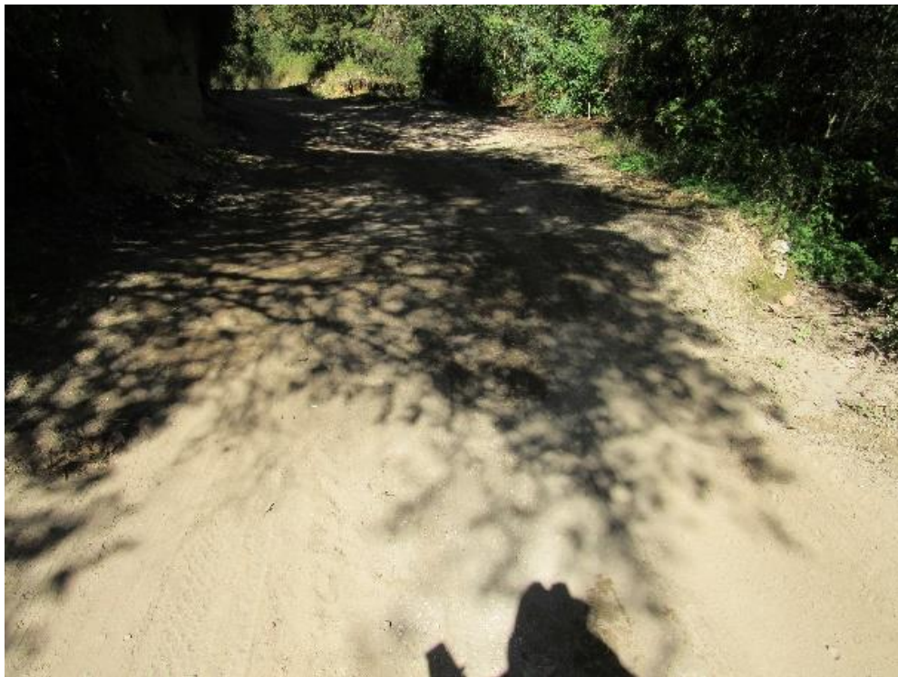
Aspecto del sitio donde ha proyectado la obra de drenaje, atraviesa un pequeño escurrimiento, no hay obra actual de drenaje
