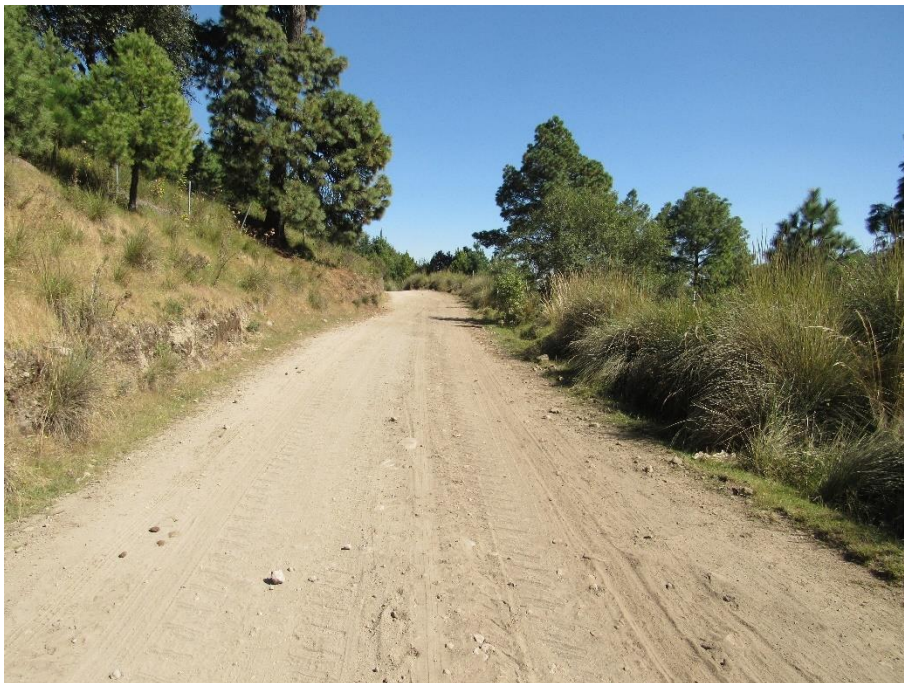
Figura 47. En el Km 6+600 hacia enfrente, se observa un camino amplio, sin que la aplicación del Proyecto afecte estrato arbóreo colindante
