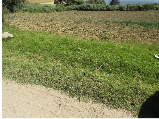
Lado derecho, afectación a cubierta de pasto
