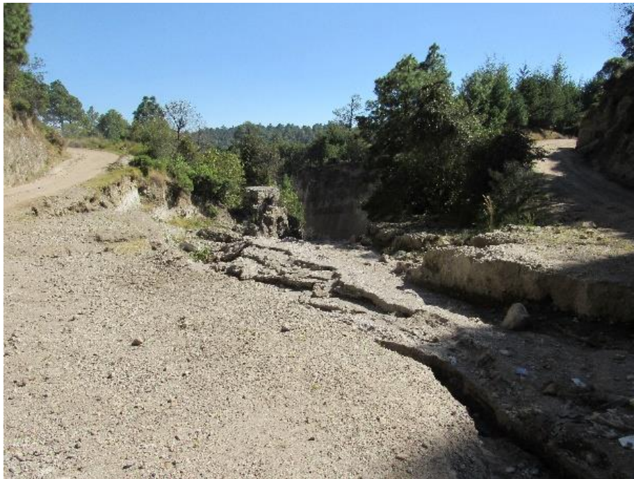
Aspecto del sitio donde se ha proyectado la obra, actualmente sufre de erosión severa, se ve que hubo una obra de drenaje pero solo quedaron algunos cimientos
